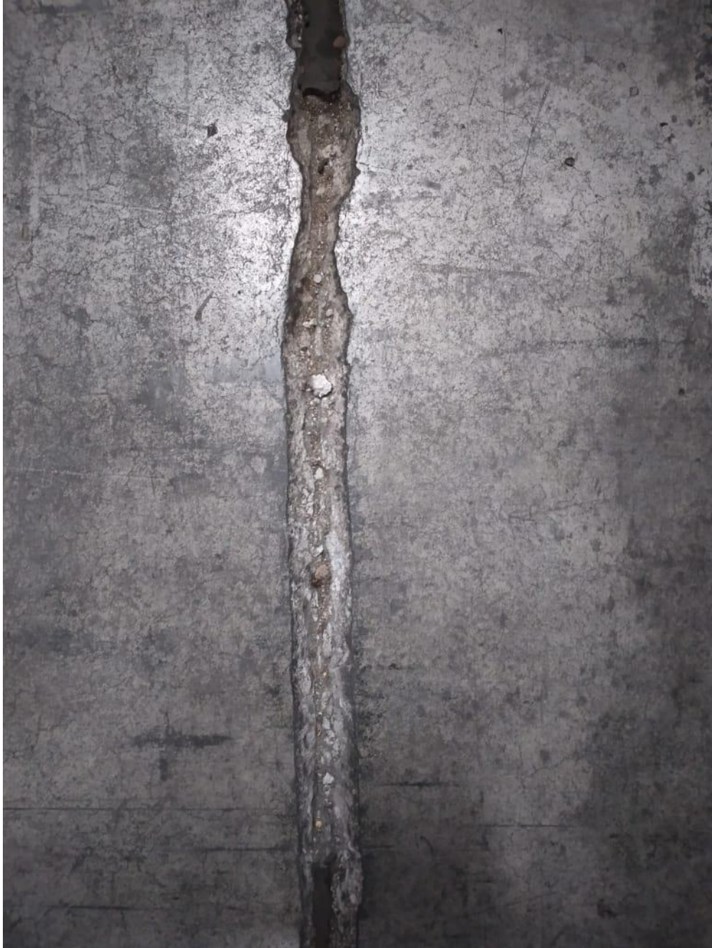
Ilustración 32: Hallazgo/ Grietas en piso
