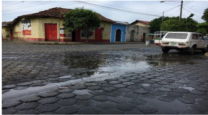
Ilustración 18: Estancamiento de aguas pluviales
