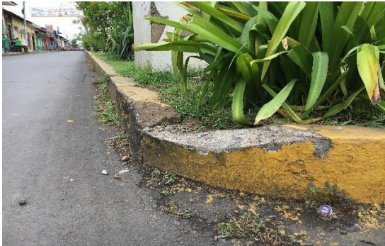
Ilustración 3: Daño en el bulevar
