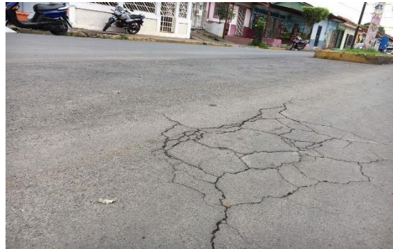
Ilustración 4: Grietas en la calzada
