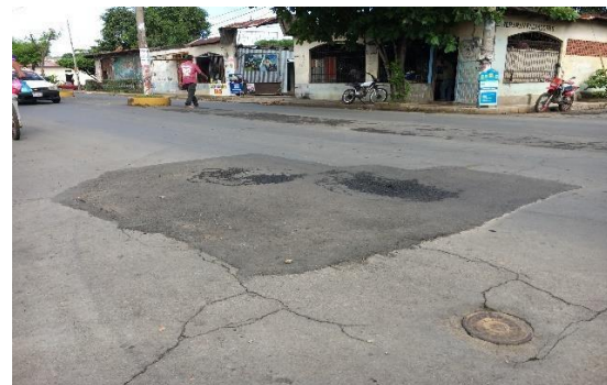
Ilustración 6: Bache y grietas en la calzada
