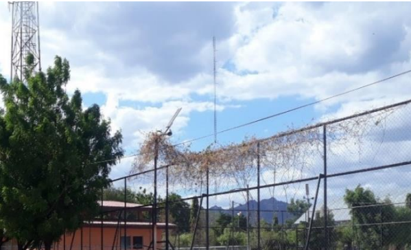
Figura 79 Cancha de Futbol en Mal Estado.
