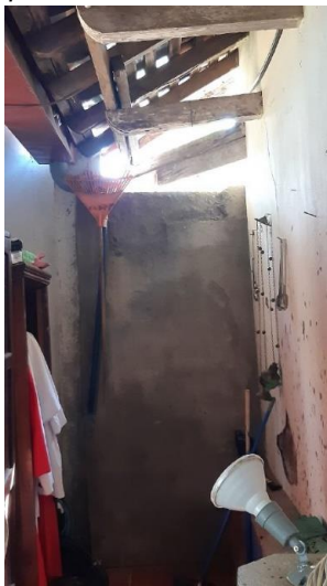
Figura 153: Desprendimiento de revoco en pared de sacristía.
