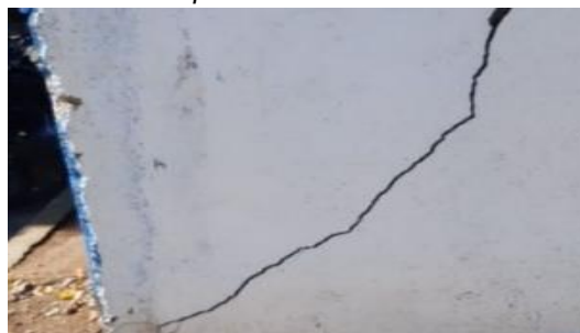
Figura 18: Grieta en esquina norte de la escuela primaria.
