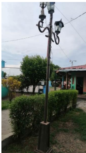
Figura 220: Oxido en Luminarias.
