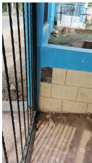
Figura 194: Alteración de muro.
