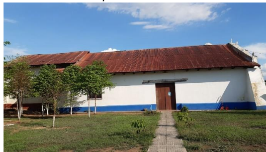
Figura 117: Deterioro de la cubierta de zinc por oxido.
