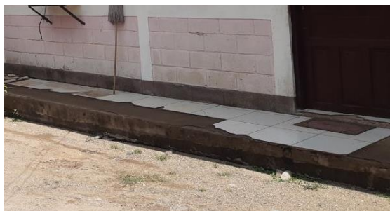
Figura 93: Desprendimiento de piso cerámico en corredor.
