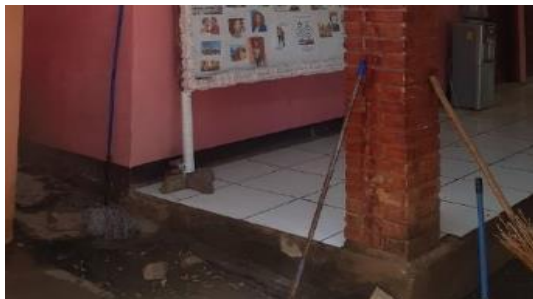
Figura 106: Deterioro en columnas Casa de los Pueblos.
