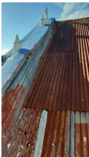
Figura 149: Oxido en cubierta de techo.
