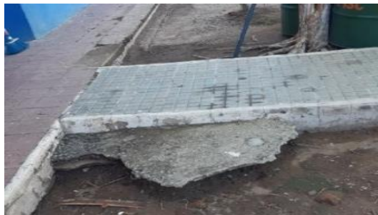
Figura 121: Desprendimiento de suelo de losa.
