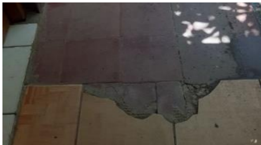
Figura 97: Fracturamiento de piso cerámico.
