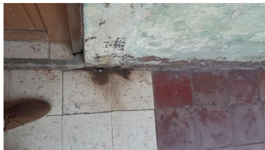
Figura 88: Manchas en pisos.
