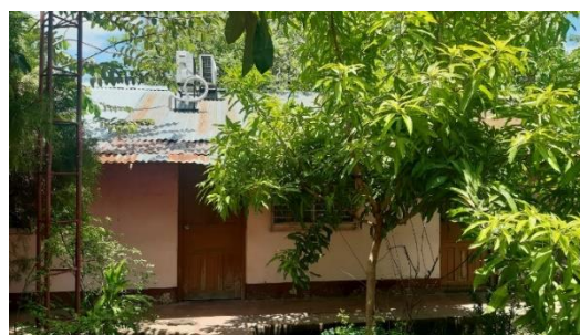
Figura 92: Deterioro de cubierta por oxido, Alcaldía.
