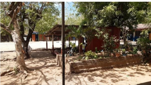
Figura 29: Grietas en jardineras.
