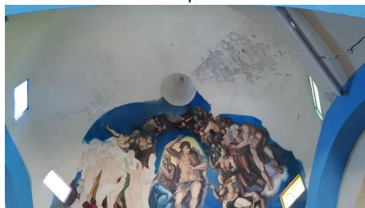
Figura 158: Desprendimiento de pintura en Área interna de Cúpula.
