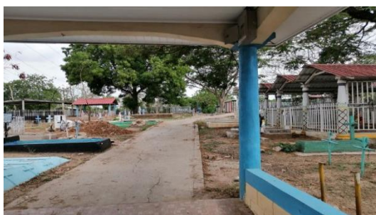
Figura 190: Fracturamiento. Fisuras en embaldosado y fracturamiento y confinamientos externos Cementerio
