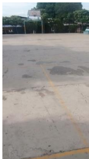
Figura 231: Disgregación de pavimento de cancha.
