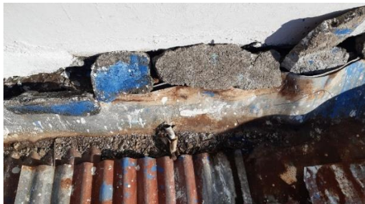
Figura 161: Mala técnica constructiva en cumbrera de empalme a fachada.
