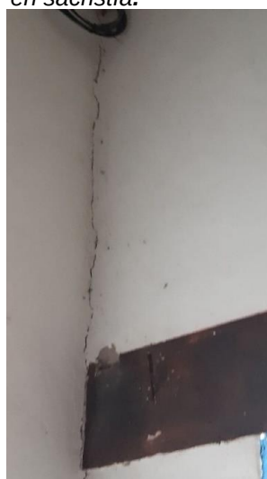
Figura 145: Fisuras en unión de paredes en sacristía.
