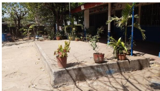
Figura 22: Deterioro de tarima.
