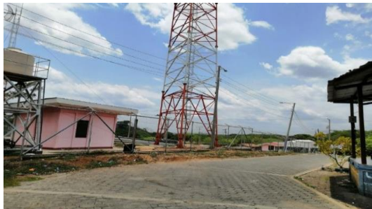
Figura 181: Vista exterior de Planta Eléctrica
