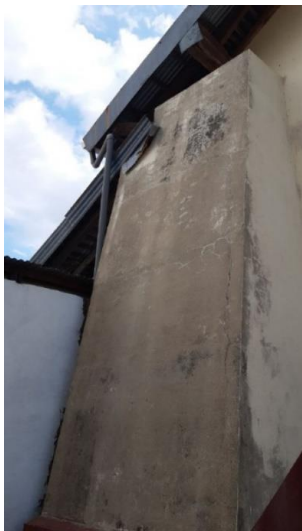
Figura 140: Deterioro por suciedad.
