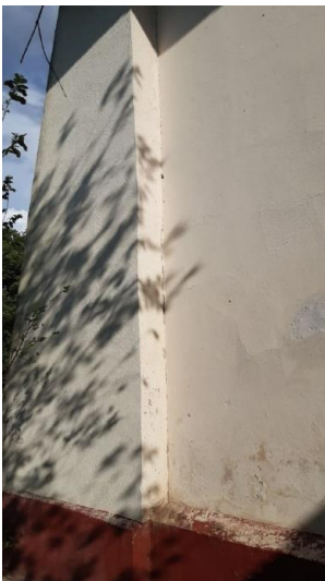
Figura 126: Deterioro por descascaramiento y suciedad de pintura en extremo este de fachada norte.
