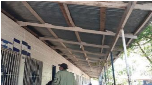
Figura 33: Decoloración en estructura de cubierta de techo.
