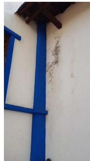
Figura 127: Manchas en pared por existencia de moho.
