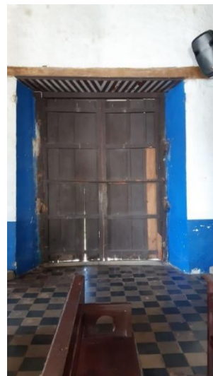
Figura 136: Deterioro en puerta norte por descamación y alteración cromática.
