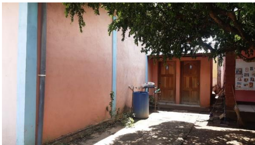
Figura 110: Fractura miento en pasillo embaldosado.
