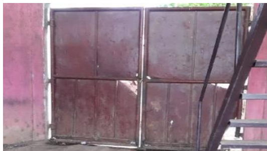
Figura 66: Deterioro de salida de Emergencia.
