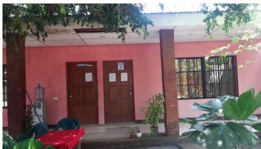
Figura 107: Deterioro por desprendimiento de cielo falso.
