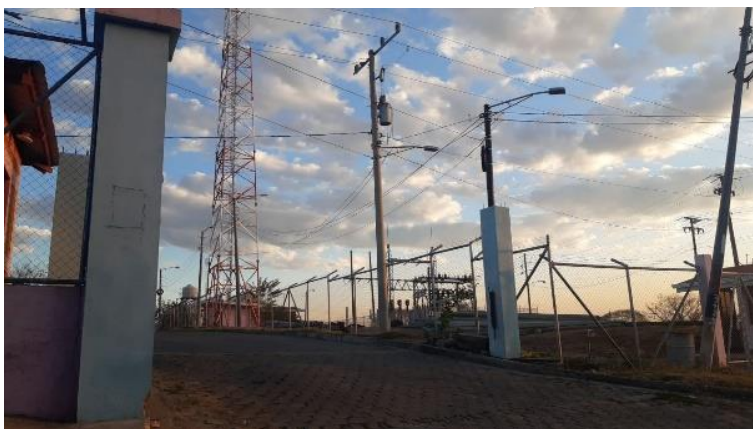
Figura 179: Perspectiva de Planta Eléctrica.
