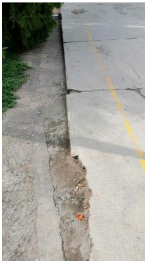
Figura 221: Grietas y desprendimiento en pavimento de cancha.
