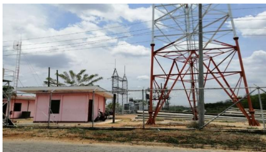
Figura 182: Decoloración de pintura en edificios de planta eléctrica.
