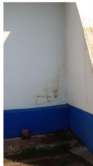
Figura 124: Manchas en esquina trasera del contrafuerte de la fachada.
