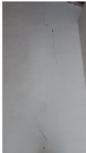
Figura 148: Fisuras superficiales en acabado de pared Sacristía.
