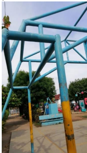
Figura 223: Descascaramiento de pintura y oxido en portería
