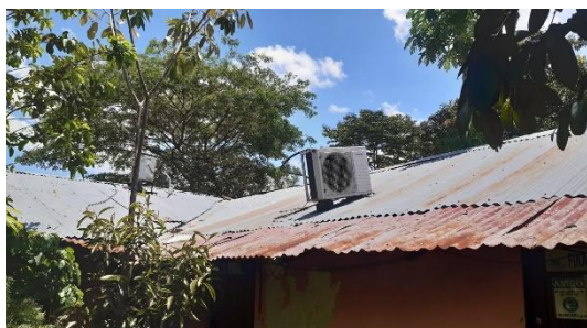
Figura 95: Deterioro en cubierta de techo, Alcaldía.
