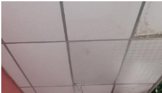
Figura 109: Hundimiento de cielo falso.
