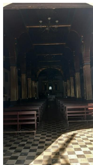
Figura 139: Vista de nave principal. Vista de nave principal en la que se observa una afectación cromática al color del piso.
