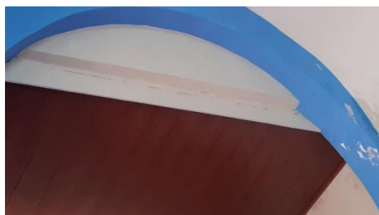
Figura 159: Desprendimiento de pintura en arco de medio punto.
