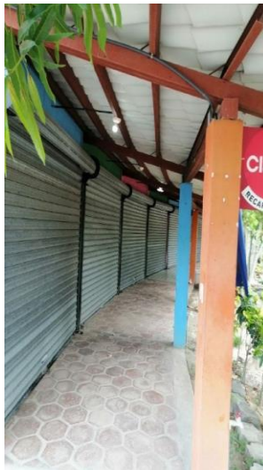
Figura 177: Decoloración de baldosas de pasillos externos del Mercado.
