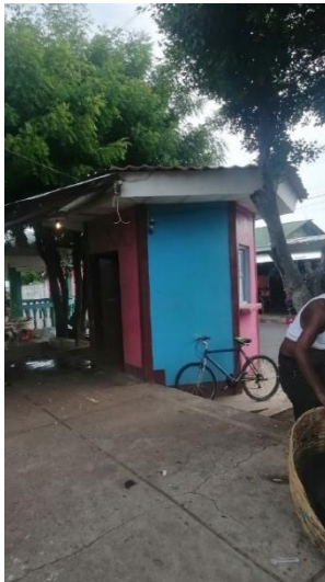
Figura 224: Desgaste en pintura de S.S.
