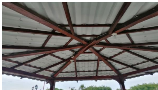
Figura 215: Decoloración en estructura de techo de Kiosco de madera.
