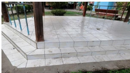
Figura 216: Manchas de suciedad en piso cerámico de Kiosco de madera.
