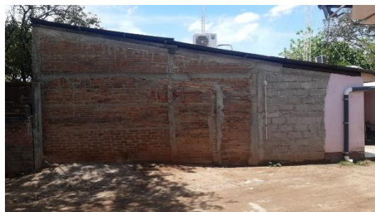
Figura 94: Disgregación de pared exterior.
