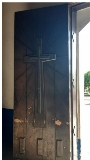
Figura 142: Deterioro en puertas principales por descamación en acabado.
