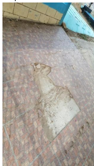
Figura 193: Desprendimiento de piso.
