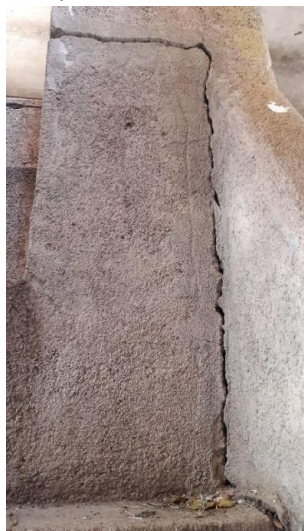
Figura 152: Grietas en pared interna del campanario.
