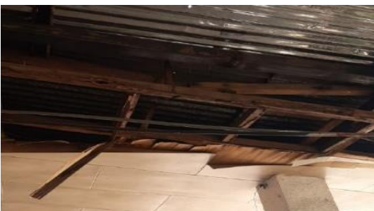
Figura 31: Desprendimiento de Cielo Razo.
