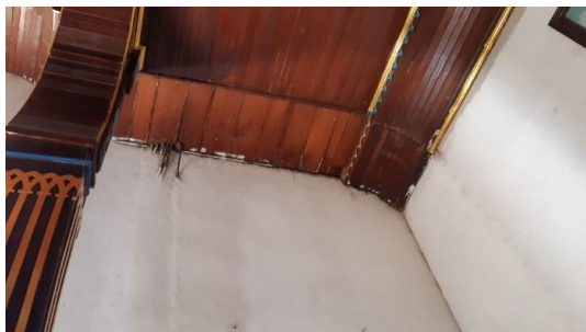
Figura 130: Alteración por alambre a la vista, mala técnica constructiva.
