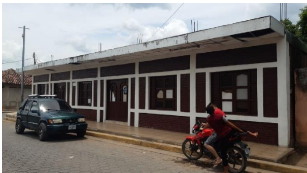
Figura 233: Alteraciones en fascia por presencia de moho y desprendimiento de cielo raso del Recreativo
