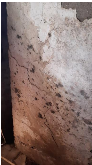
Figura 147: Grietas y desprendimiento de revoco en pared de campanario.
