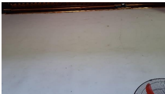
Figura 132: Fisuras leves en paredes.
