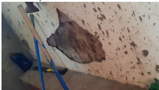
Figura 157: Desprendimiento de revoco en pared de sacristía.
