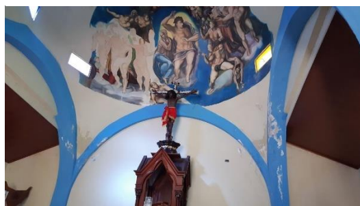
Figura 160: Desprendimiento de pintura en pechinas de Capilla del Santísimo.
