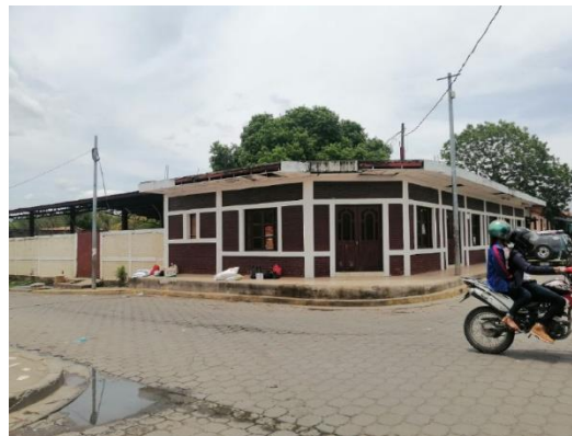
Figura 234: Desprendimiento de fascia y presencia de moho, además se presenta una decoloración de pintura
