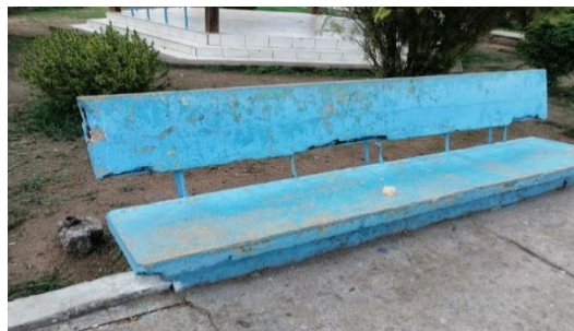
Figura 209: Desprendimiento de material en banca de concreto.
