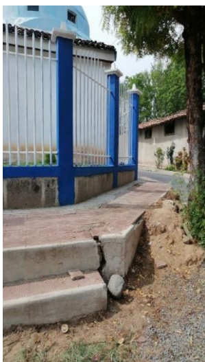
Figura 150: Grietas en borde de acera sureste.
