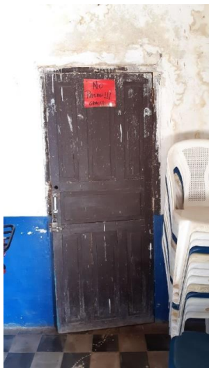
Figura 135: Puerta del campanario en deterioro.
