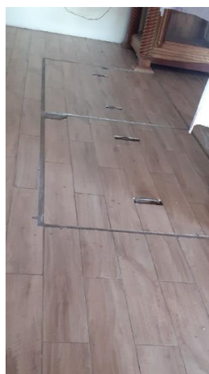
Figura 151: Mal acabado en trabajo de suelo de porcelanato en Capilla del Santísimo
