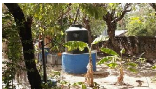
Figura 44: Mal estado de Tanque de agua.
