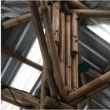
Figura 19: Estructura de techo empernada y refuerzo con sogas (Fuente propia)
