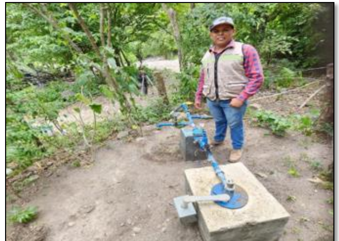
Figura 52. Estación de Bombeo Agua Potable.
