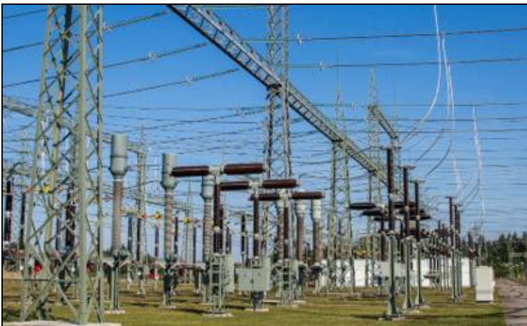
Figura 55. Subestación Eléctrica Carlos Fonseca/ Malpaisillo.
