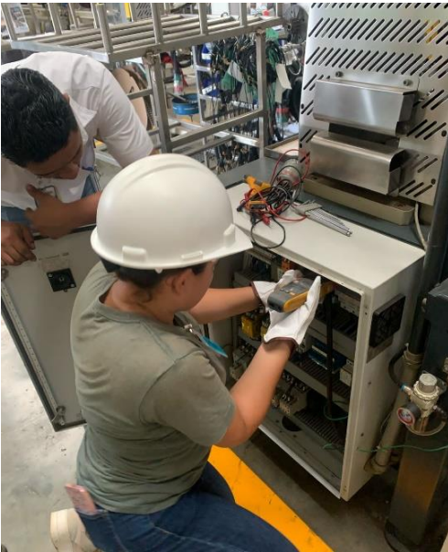
Figura 23. Medición de voltaje a las máquinas
