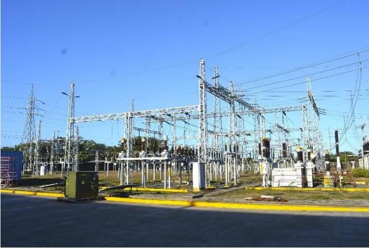
Figura 46 Subestación León II.
