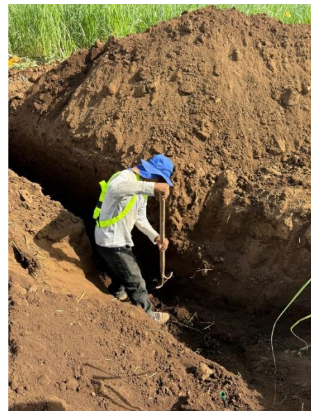
Figura 9 Uso Incompleto de EPP
