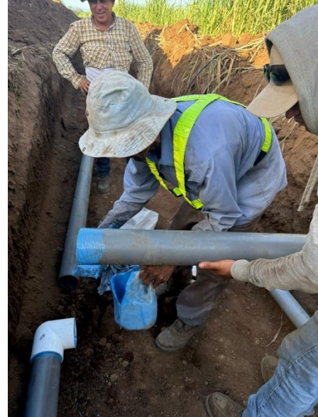
Figura 13 Falta de utilización de guantes para manipulación de químico (pegamento PVC)
