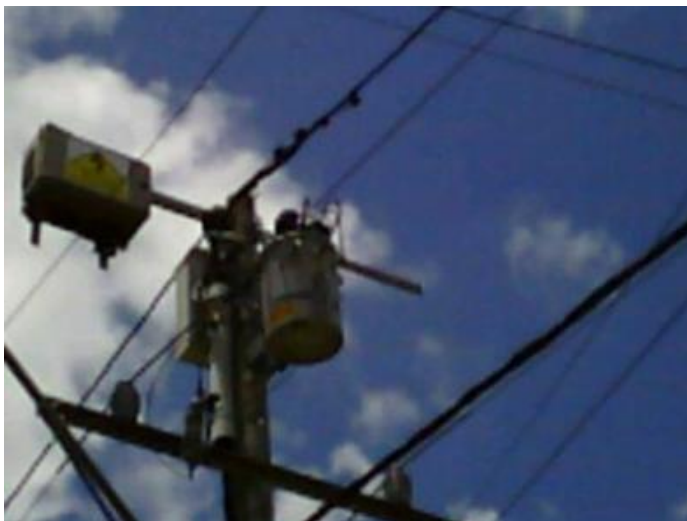
Figura 24 Luz Visible Centro de Transformador
