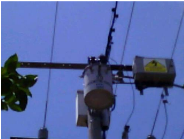
Figura 20 Luz Visible del Centro de Transformación matrícula W1484
