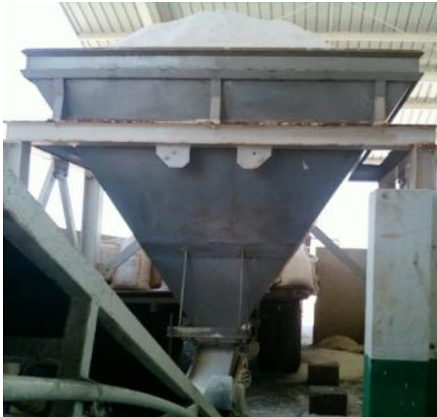
Anexo 4 Tolva de recepción de materia Prima
