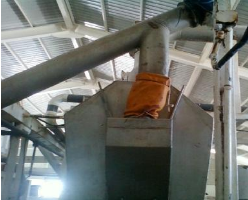
Anexo 17 Conductos de flujo de aire
