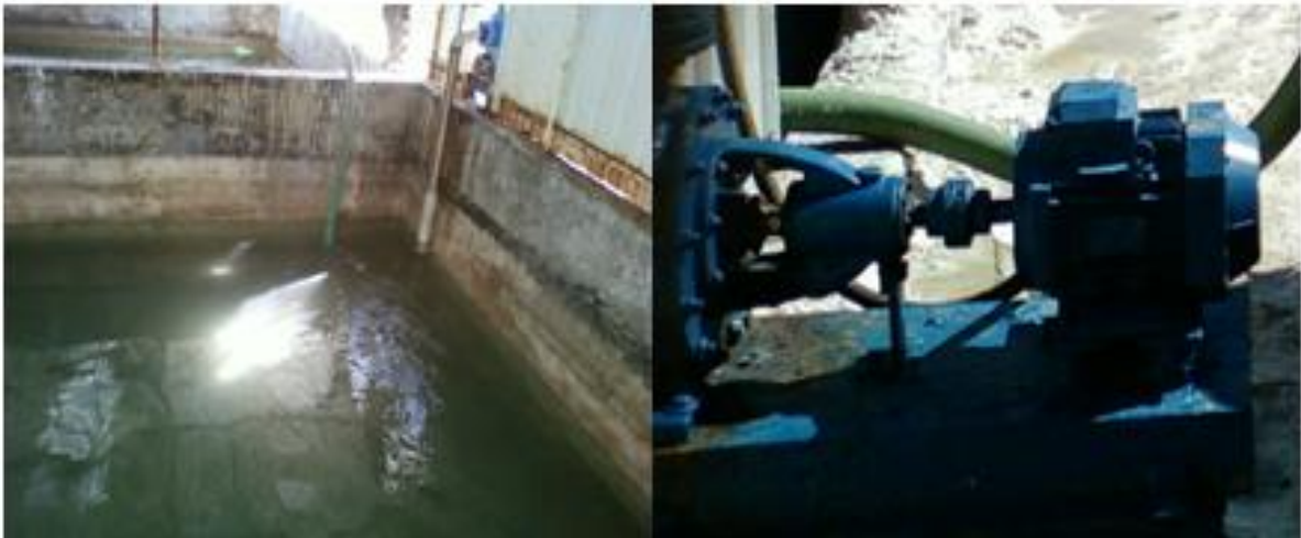
Anexo 7 Pila N° 1 y Bomba Centrifuga
