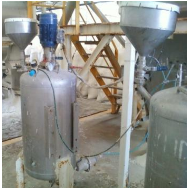
Anexo 16 Tanques dosificadores
