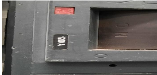
Figura 15 Capacidad nominal de 1200 A del breaker principal de panel de distribución
