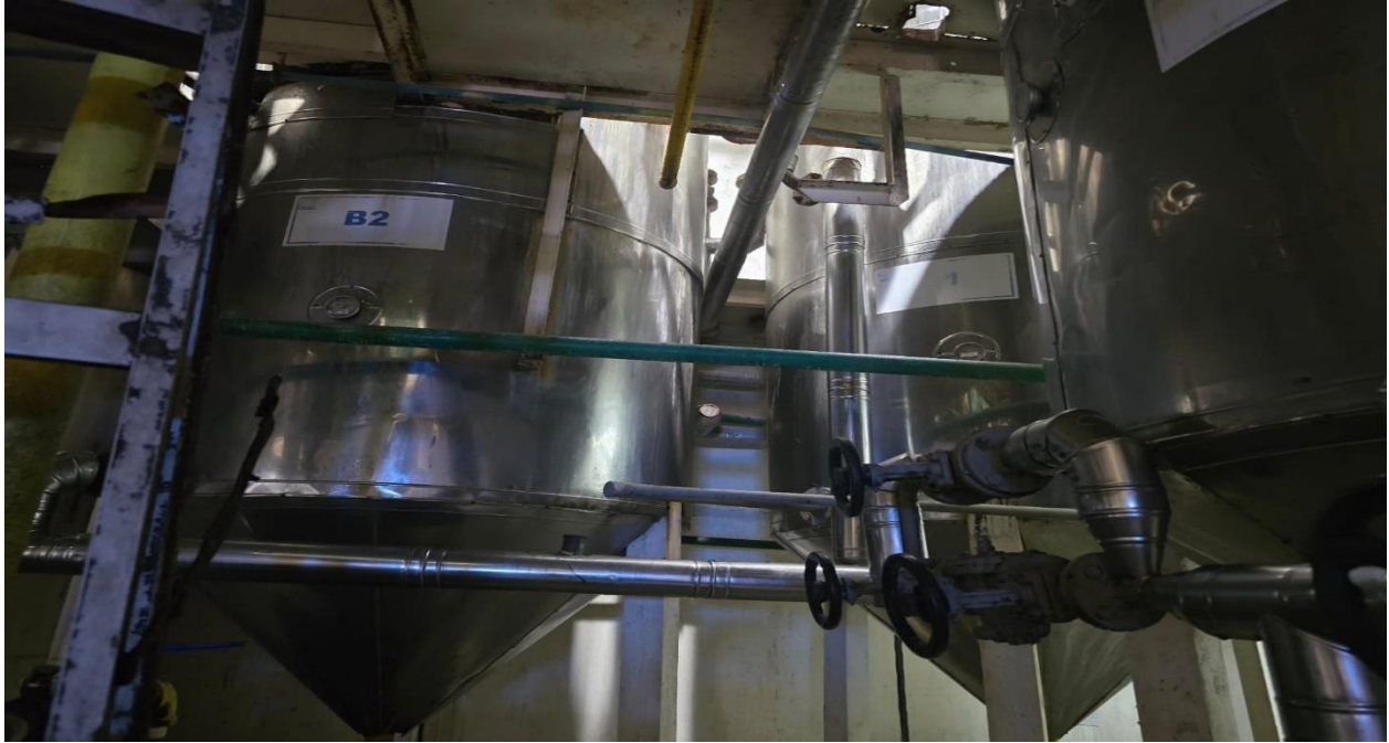
Tanque de blanqueo
